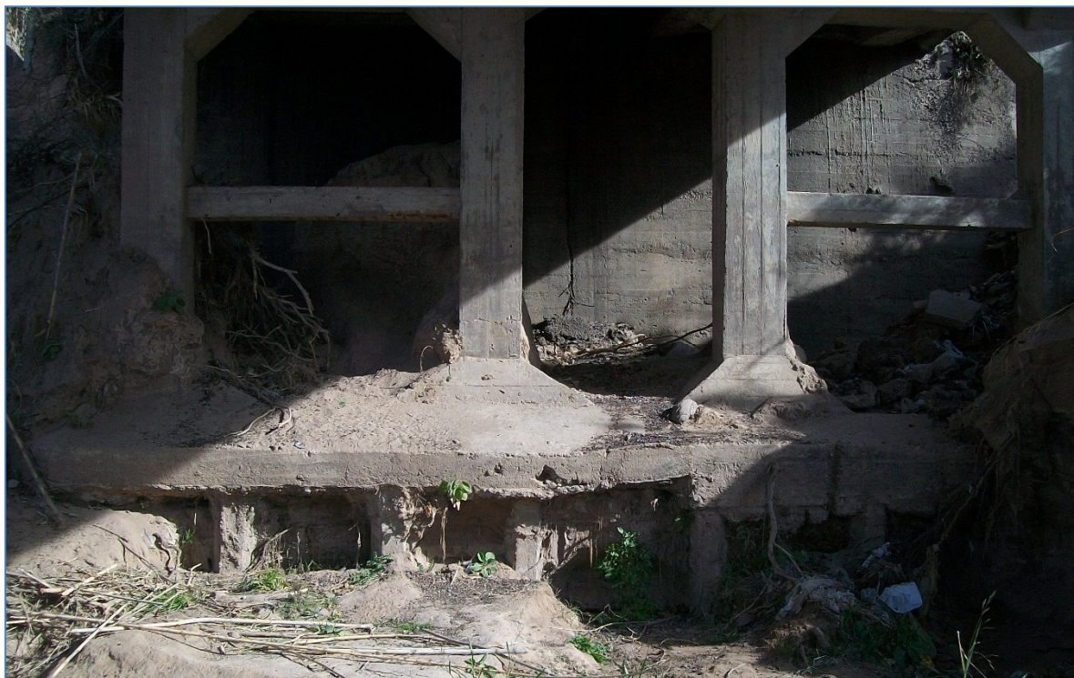
Foto N° 2: Erosión en pilas (en la actualidad protegida parcialmente – ver Foto N°3)
