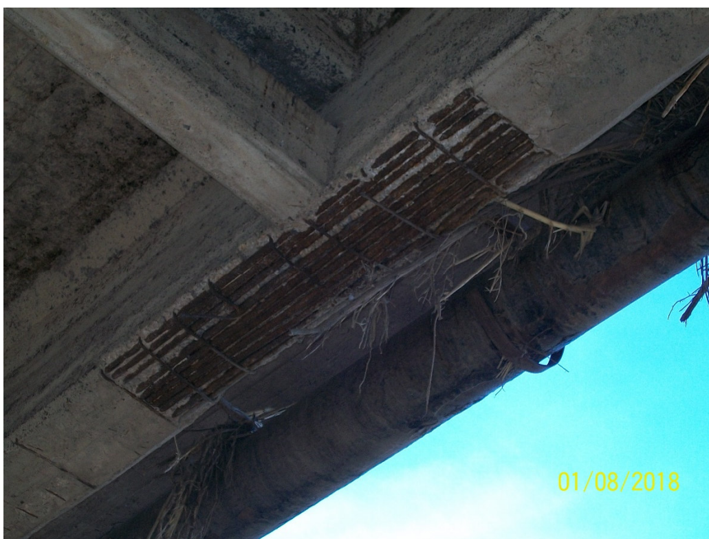
Foto N° 5: Grave situación estructural por pérdida de recubrimiento de armaduras, con reducción de sección de acero en vigas principales.
