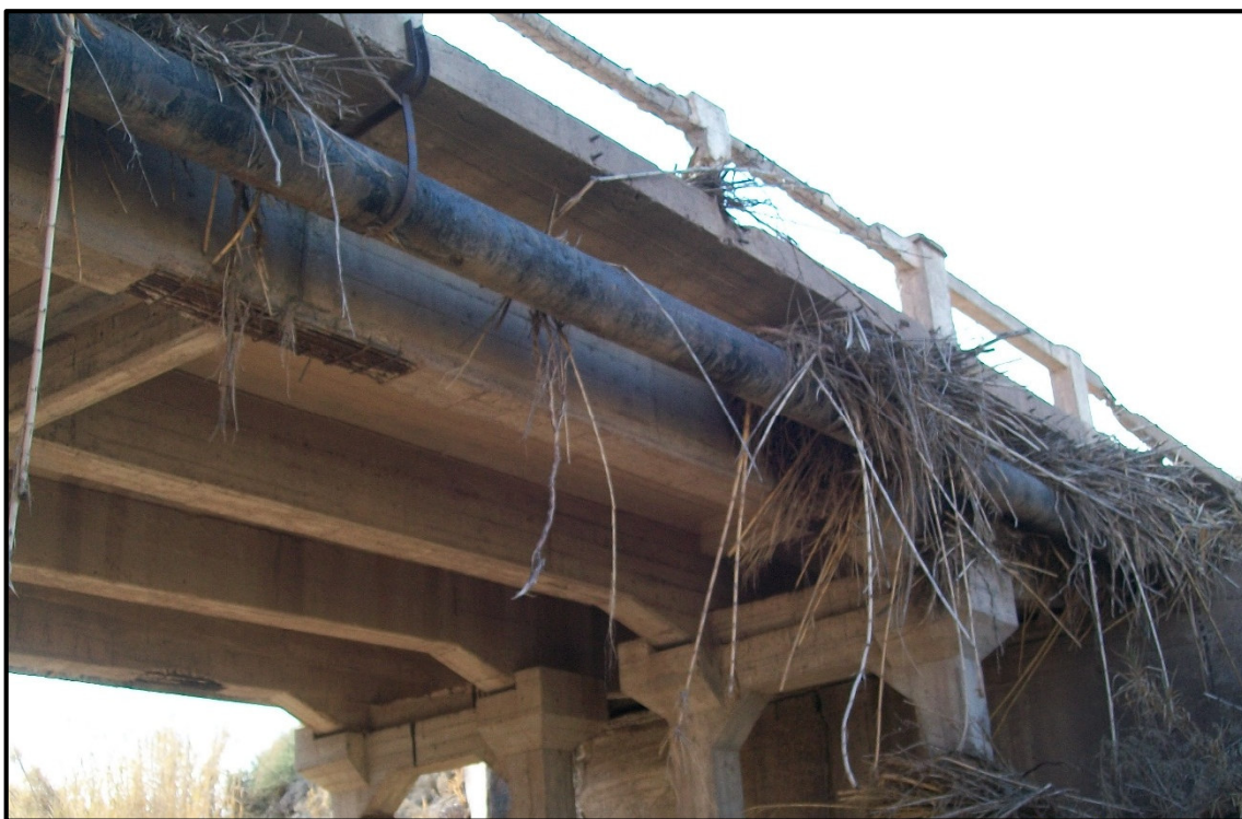
Foto N° 1: Obstrucción de material flotante por insuficiencia de sección hidráulica, alcanzando la altura de las barandas de protección vehicular, se puede observar que el mismo ha sido sobrepasado por el paso de crecidas.
