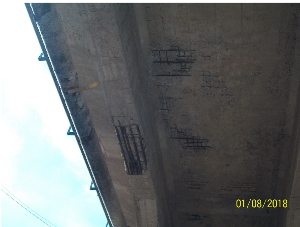
Foto N° 4: Estado de carbonatación del hormigón y exposición de armaduras con reducción de sección de acero en tablero y vigas principales.
