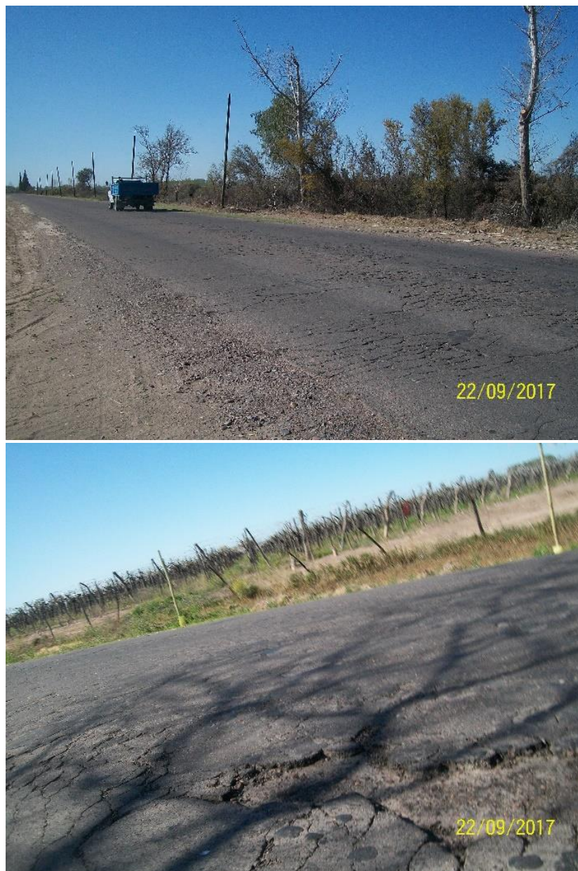
Fotos: Estado del pavimento actual sector semirural
