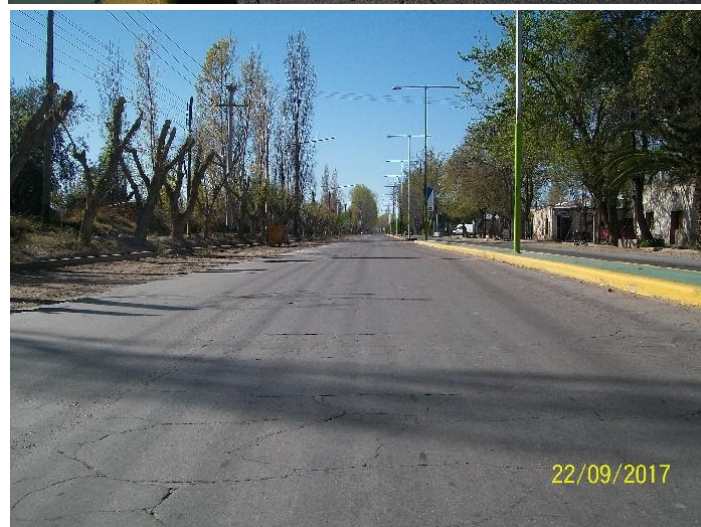
Fotos:-Estado del pavimento actual en Phillips
